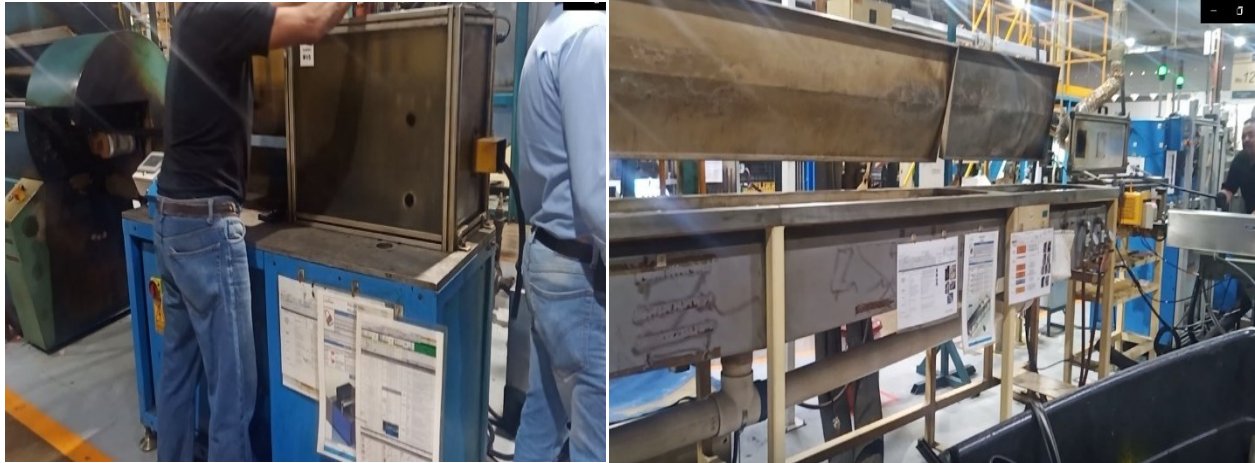
Ilustración 90 Enfriadores y secadores segunda sección de la línea Cooper Standard. Fuente: Elaboración propia, 2022
